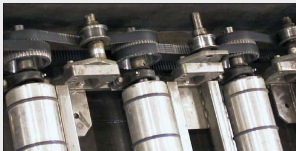
Příklad pohonu válečkové trati ve sklářském průmyslu řemenem S08M-1000-24 EXTREME po 1 roce bezproblémového provozu (P=0,50kW, Mk=227Nm, n=21ot/min)
